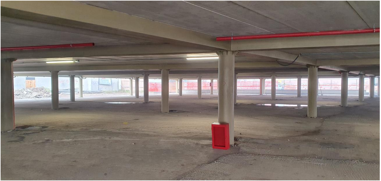
FOTO N. 4 – Piano terra – Impianto antincendio
