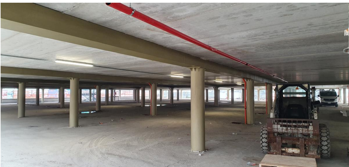
FOTO N. 3 – Piano terra – Impianto antincendio
