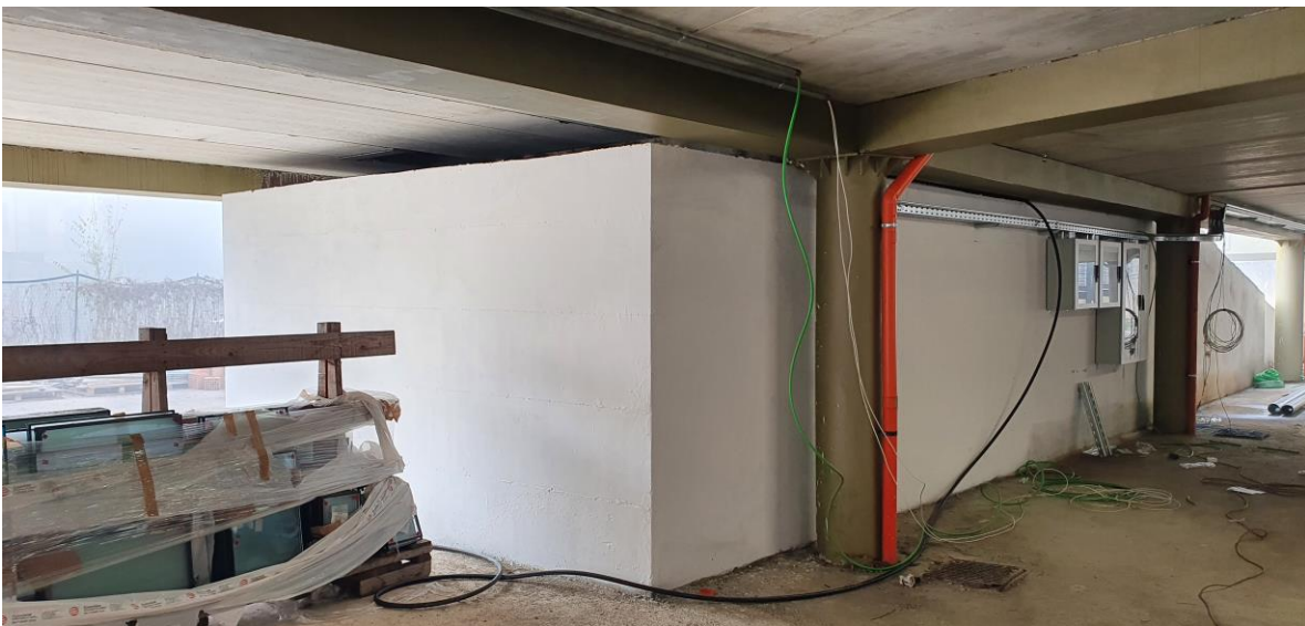
FOTO N. 9 – Locale impianti – riserva idrica
