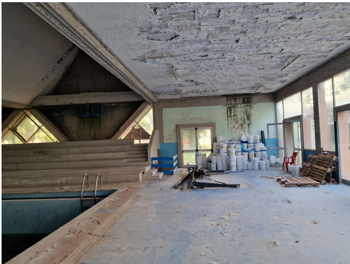
Particolare solaio ex vasca oggetto di infiltrazioni e conseguenti sfondamenti
