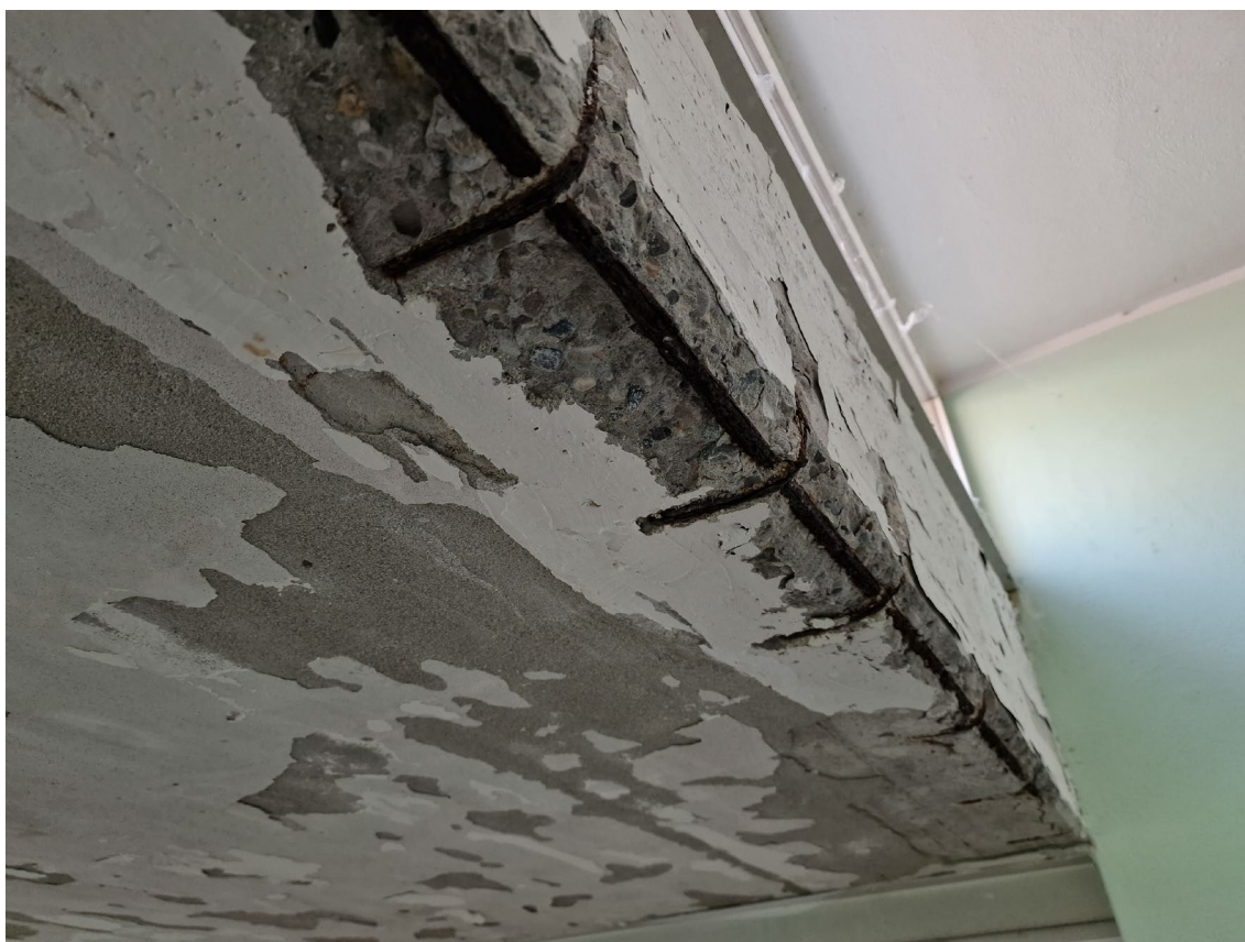
Particolare del distacco del copiferro presso le armature delle travi esistenti
