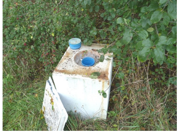
Piezometro monitoraggio ambientale AEM (id. 12)
