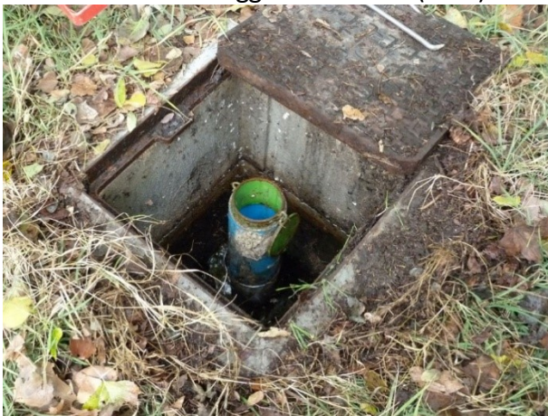
Piezometro monitoraggio ambientale AEM (id. 14)
