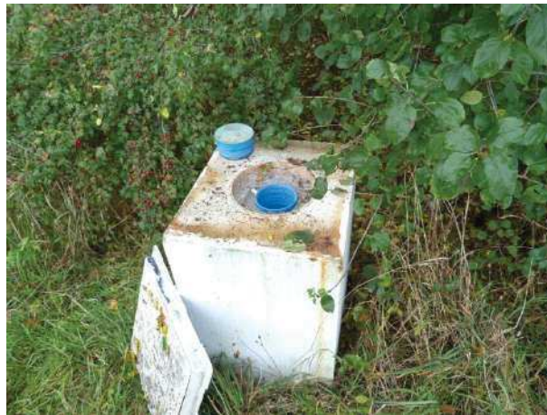
Piezometro monitoraggio ambientale AEM (id. 12)
