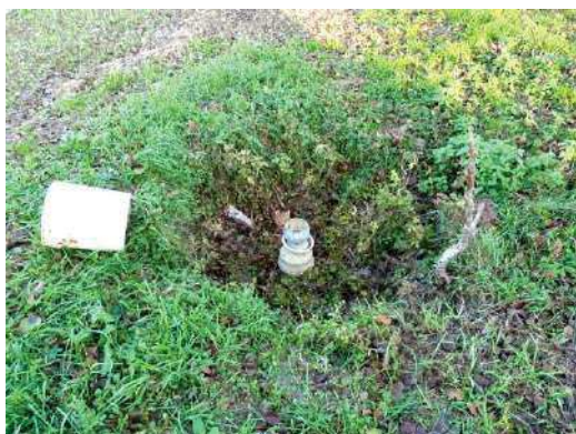
Pozzetto agricolo aperto, senza pompa propria (id. 26)
