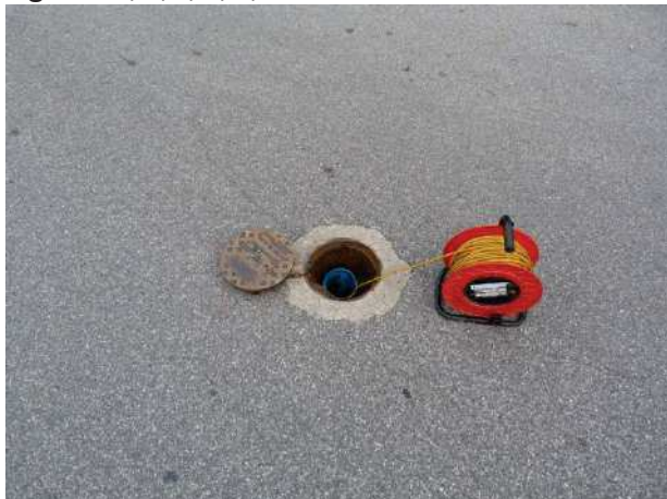
Piezometro monitoraggio ambientale (id.27)
