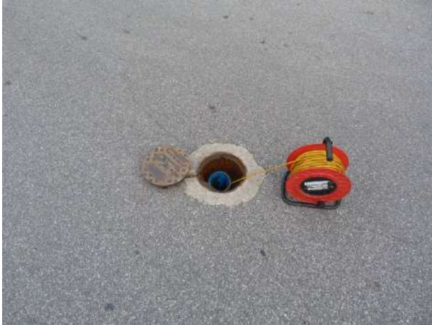
Piezometro monitoraggio ambientale (id.27)
