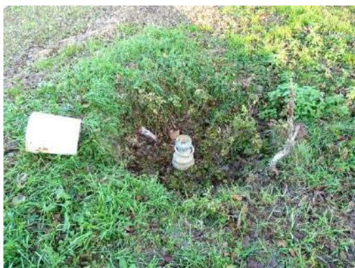
Pozzetto agricolo aperto, senza pompa propria (id. 26)
