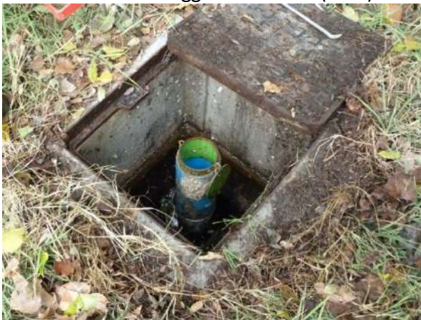
Piezometro monitoraggio ambientale AEM (id. 14)
