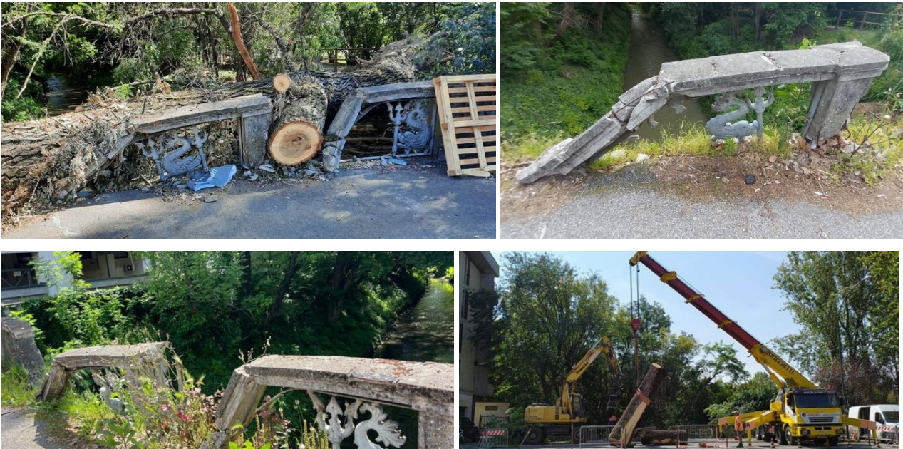
fig. 1. Foto d'archivio – ponte nel suo stato collabente al momento della caduta dell'albero (fonte: web)
