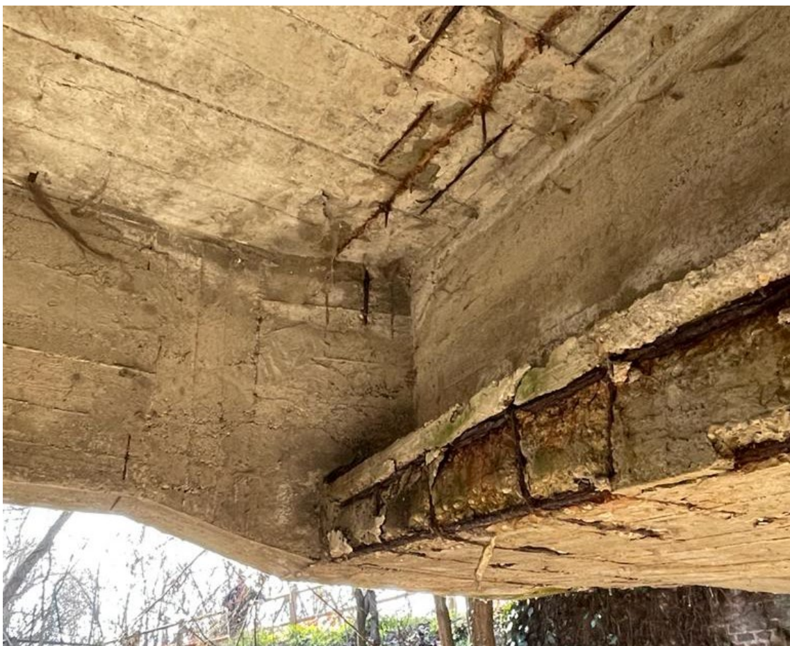
Viste da sotto il ponte del degrado della soletta in c.a. e della mensola
