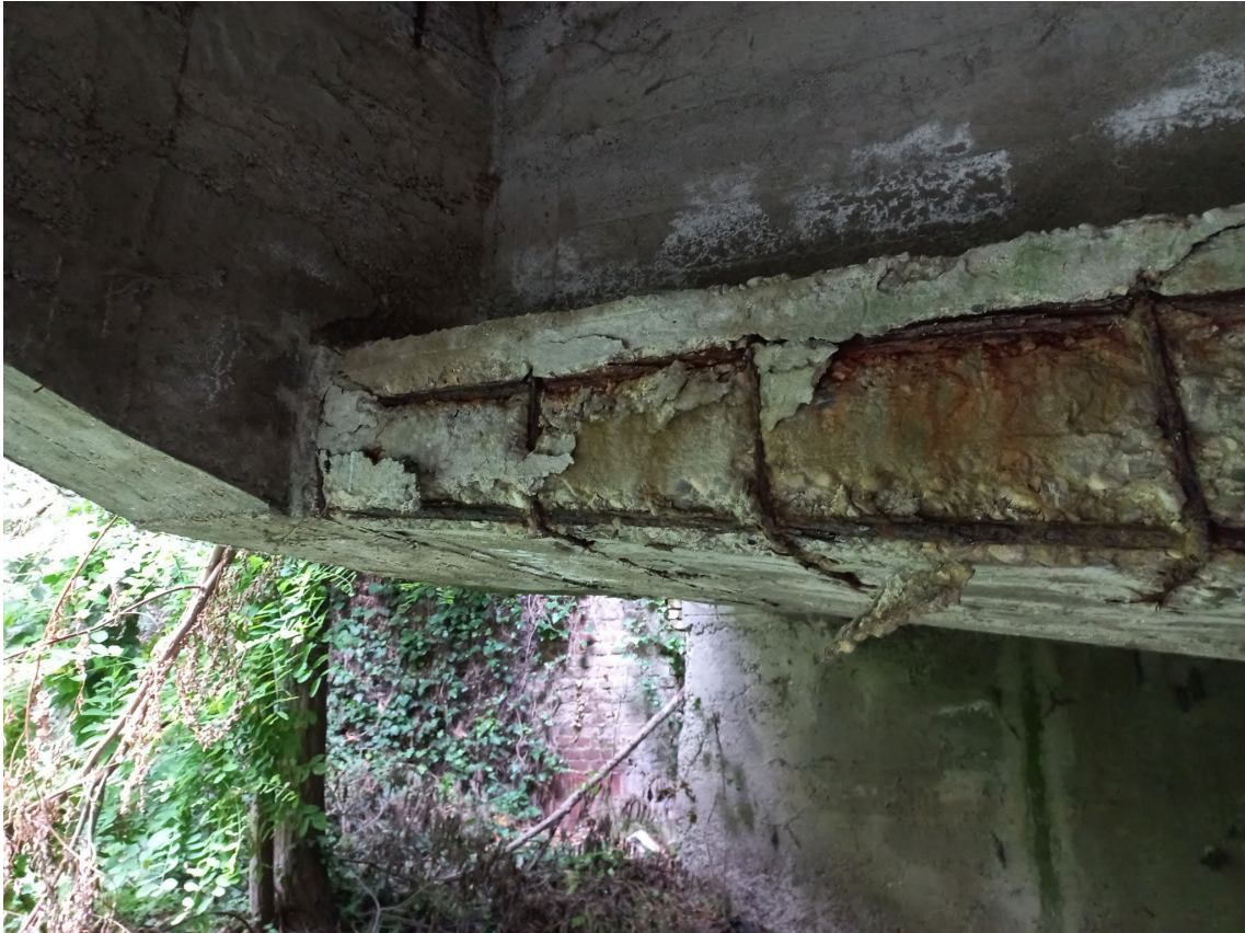
Viste da sotto il ponte del degrado della mensola in c.a.
