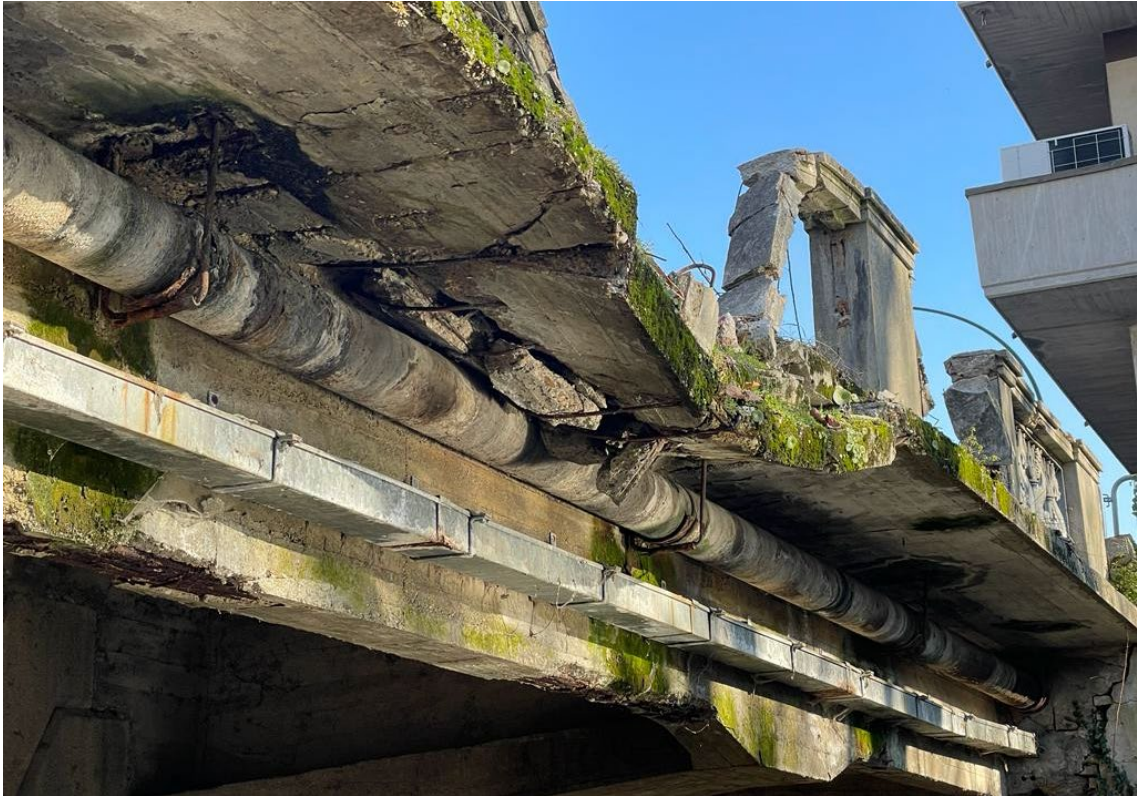
Viste da sotto il ponte della soletta collassata
