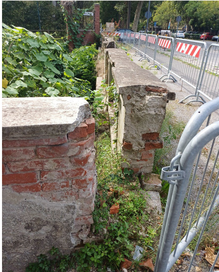
Figura 4 Vista angolo parapetto demolito
