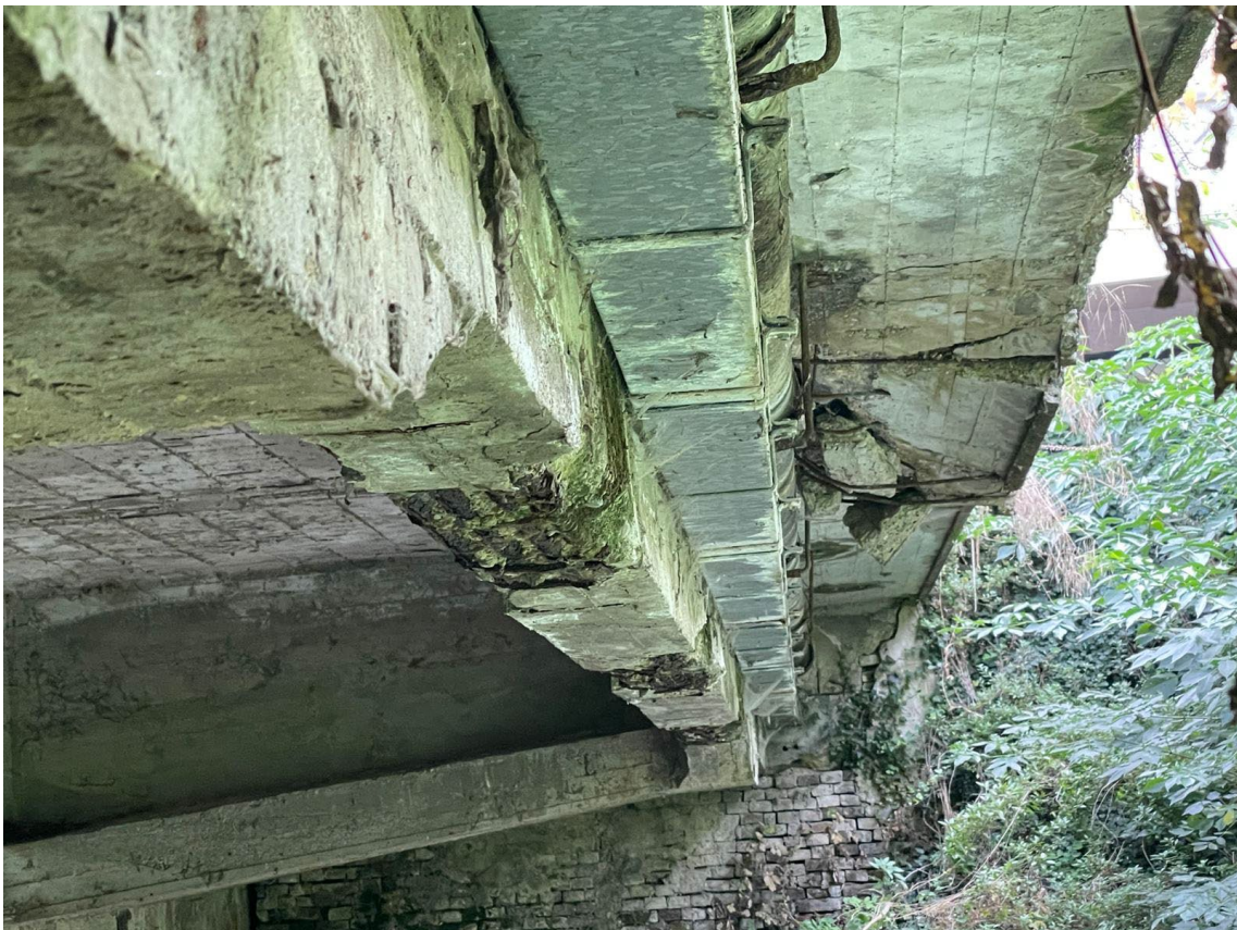
Viste da sotto il ponte del degrado della trave in c.a.
