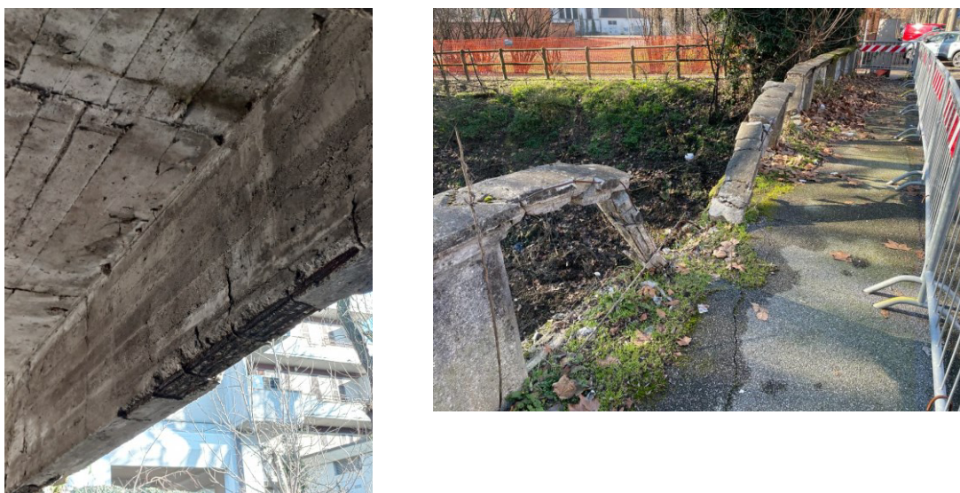
Figura 8 – Trave di bordo e balaustra sud - Stato di fatto
