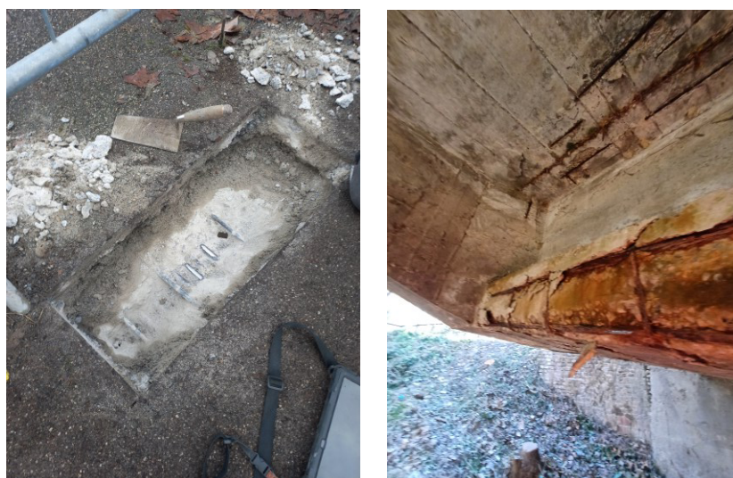
Figura 7 – Saggio estradossale mensola e stati di degrado mensola e trave sud - Stato di fatto
