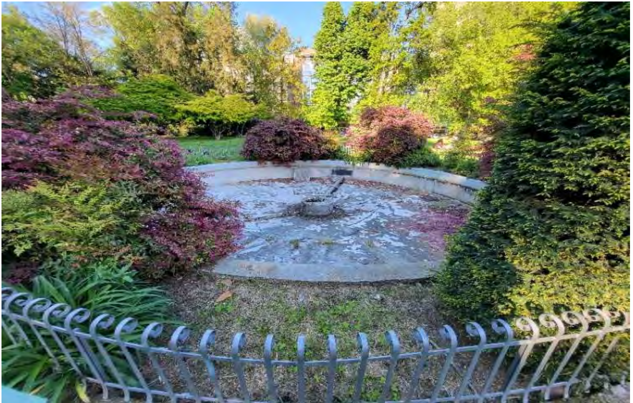
Immagini dello stato attuale della fontana centrale, nelle quali sono visibili l'invasione della vegetazione e lo stato del rivestimento impermeabilizzante; è probabile che recinzione metallica e vegetazione siano stati collocati per problemi di sicurezza e vandalismo
